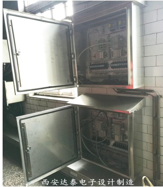
119CX 和 219CX 卸料车无线传输方案实景安装图 ▼
